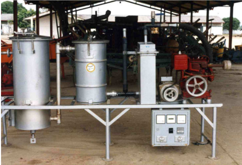
Abb. 18: Holzkohle-Gasgeneratoranlage in Montería, Kolumbien (1990). Von links nach rechts: Generatorkessel, Absetzbehälter, Filterbehälter, Wechselstromgenerator 3 kW, Motor.
